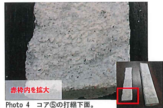
Photo 4 コア⑤の打継下面。レイタンス（表面の白い物質）が多量に存在し、砂目は認められない。
